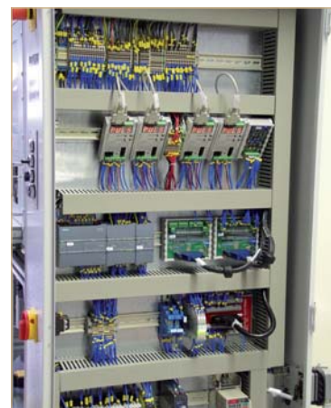
Cœur de l'installation de la technique de commande : l'armoire de commande comporte entre autre les quatre unités de contrôle d'éclairages de chez Gardasoft.
