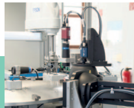
01 Zahlreiche Automatisierungs- und BV-Systeme sind in der Zorn-Anlage verbaut
